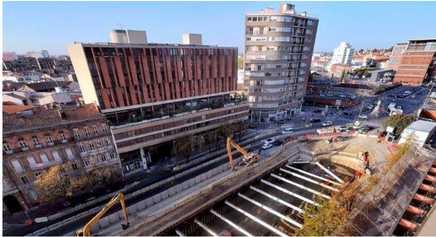
Le chantier du nouveau parking et des allées Jean-Jaurès, en octobre 2017./ DDM illustration, Xavier de Fenoyl
